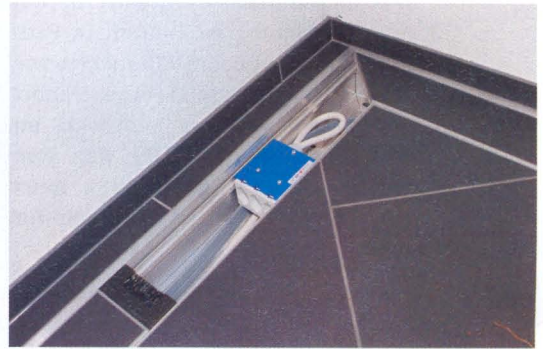
Flexibilität: Bodenkanal im Wohnraum. (Simonfoto.ch)
